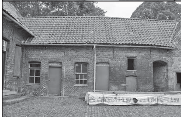
Aile effondrée aujourd'hui : elle abritait une porcherie et un four à pain.
